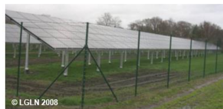
Blick auf eine Photovoltaikanlage
